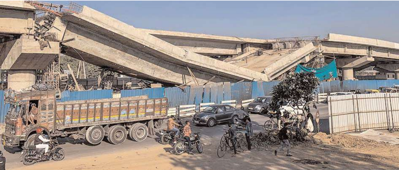
अहमदाबाद में एसपी रिंग रोड पर निर्माणाधीन फ्लाईओवर का एक हिस्सा गिर गया।
